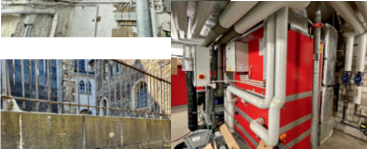
Tiefer Einblick: Der Heizungskeller unter dem Aachener Dom. (Noch) kein schöner Anblick: Mauer vor der Nikolauskapelle.
