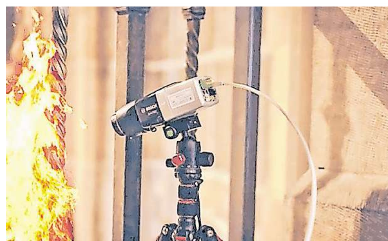
Für den Brandschutz im Aachener Dom werden künftig auch Kameras eingesetzt, die die geringste verdächtige Rauchbildung sehen und Alarm auslösen.
